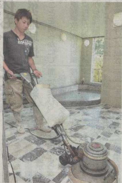
低コスト、短工期で効果が得られる溶剤を用いた床の滑り止め工事の様子＝13日、香美町香住区境のファミリーイン今子浦
